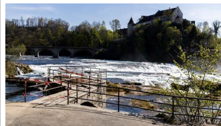
Risse im Mauerwerk setzten dem Känzeli zu. Bild: Roger Hofstetter
