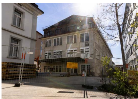
Am künftigen Standort auf dem SIG-Areal haben die Vorbereitungen für das neue Hotel bereits begonnen. Bild: Roger Hofstetter
